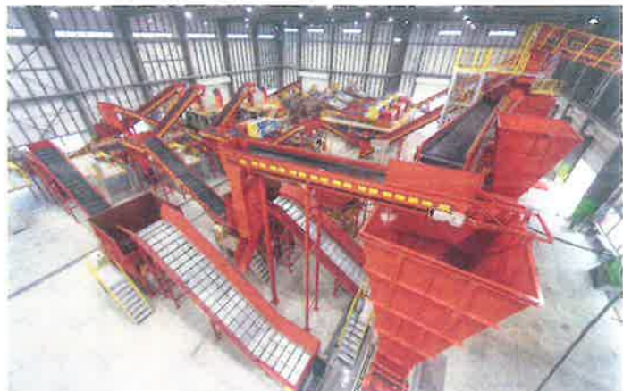
成田工場に新設した大規模な飲料容器再資源化設備
